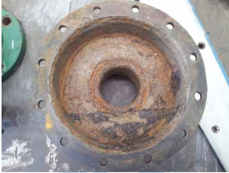
Fig. 28 – Una de las tapas del enfriador de máquina principal, mostrando severa corrosión.
