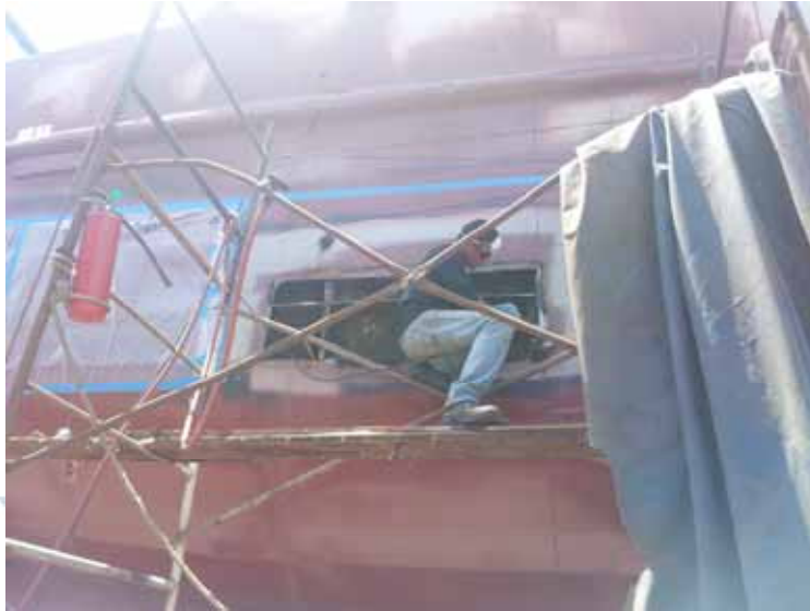
Fig. 36 – Se termina de quitar la placa de casco dañada en costado de estribor.
