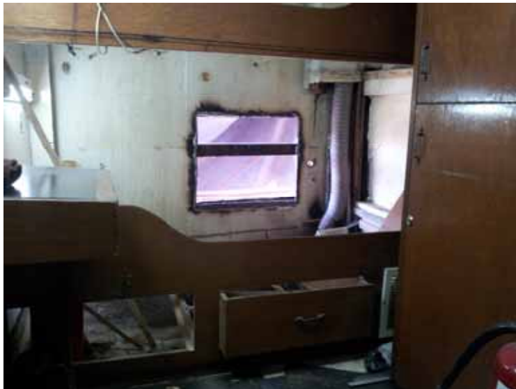
Fig. 37 – Vista de corte parcial de placa doble forro interno en camarote de oficiales de máquinas.
