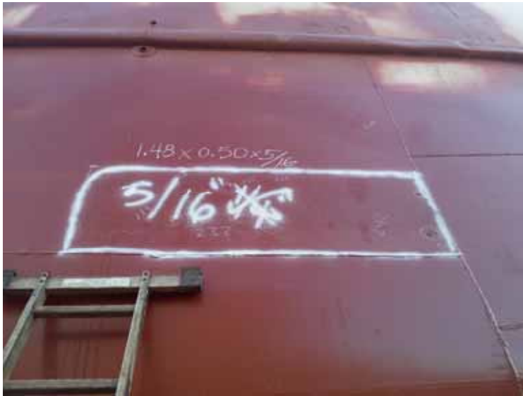
Fig. 21 – Área de placa a renovar, por estribor, correspondiente a forro de camarote de jefe de máquinas (148cm x 50cm con placa de 5/16”).
