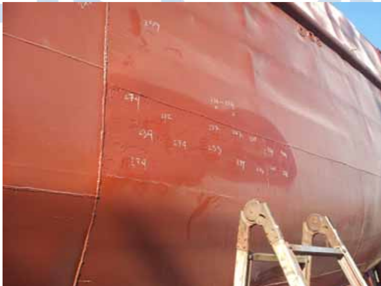
Fig. 18 – Área sospechosa en la banda de babor, correspondiente a forro de taller de máquinas.
