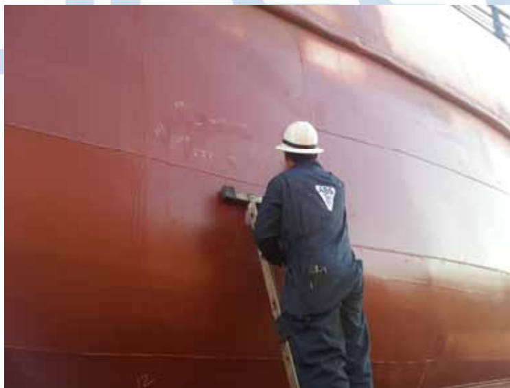
Fig. 20 – Inspector de la casa clasificadora ABS examinando el área sospechosa en la banda de estribor.
