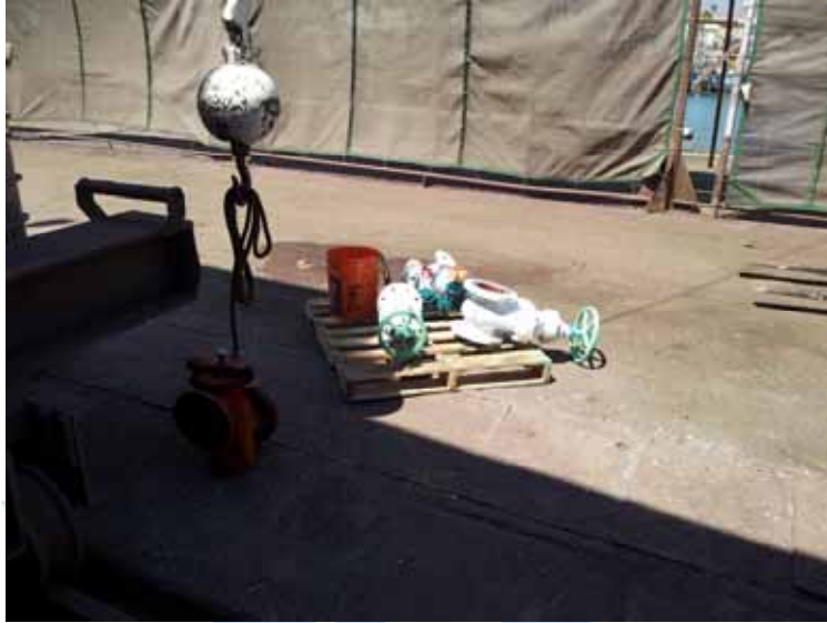
Fig. 32 – Válvulas listas para instalar y válvula que irá a mantenimiento.
