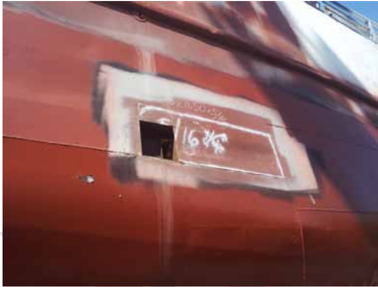
Fig. 34 – Iniciado el corte de placa de casco en costado de estribor. Arriba la obra muerta sin base.
