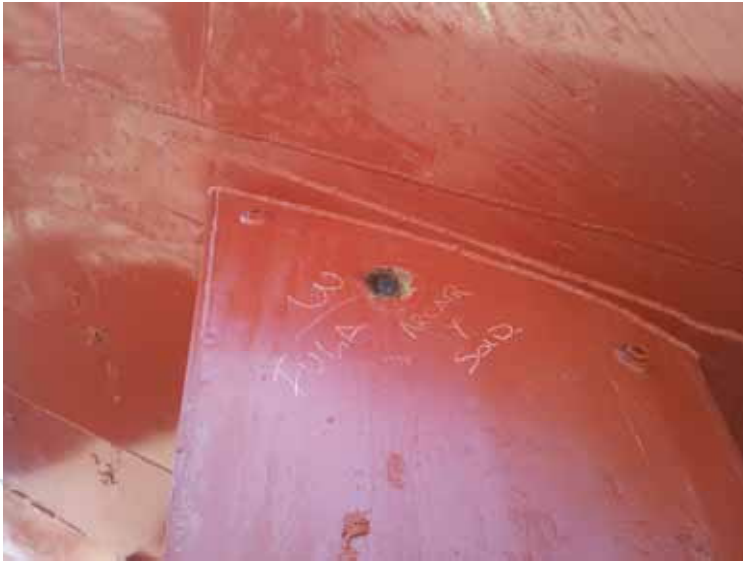
Fig. 24 – Reparación de la fuga del estabilizador de popa estribor.
