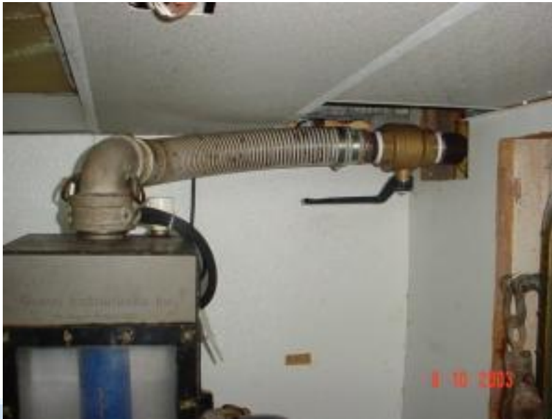
Foto 8. Porción de la manguera que comunica la bomba de succión con el concentrador. Se aprecia una válvula de control junto al pasamamparo.
