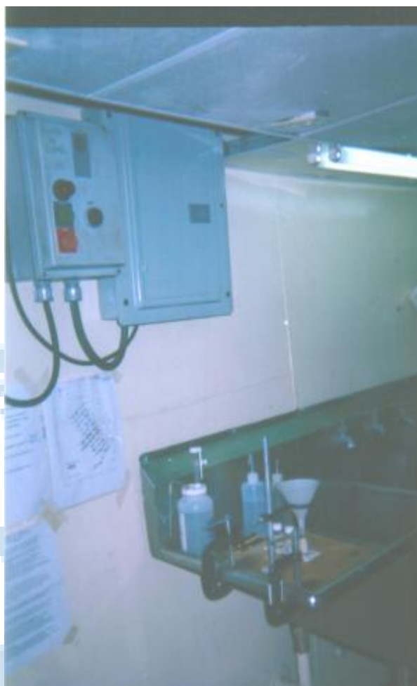
Foto 6. Arriba a la izquierda se aprecian las dos cajas de control con los interruptores y fusibles para el encendido o apagado de la bomba de succión y del motor del concentrador de CUFES, situados frente al concentrador, en el laboratorio húmedo.
