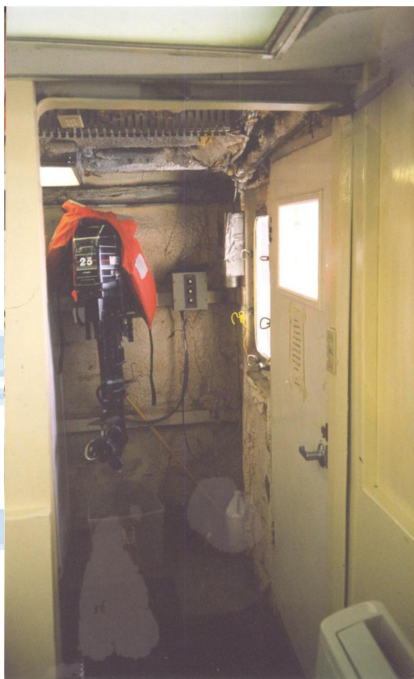
Foto 3. Esquina del laboratorio húmedo del B/O Francisco de Ulloa, donde se tenía un motor fuera de borda para una lancha, pero que se quitó para instalar el concentrador y colector del sistema CUFES. La puerta comunica con la cubierta de popa del barco.
