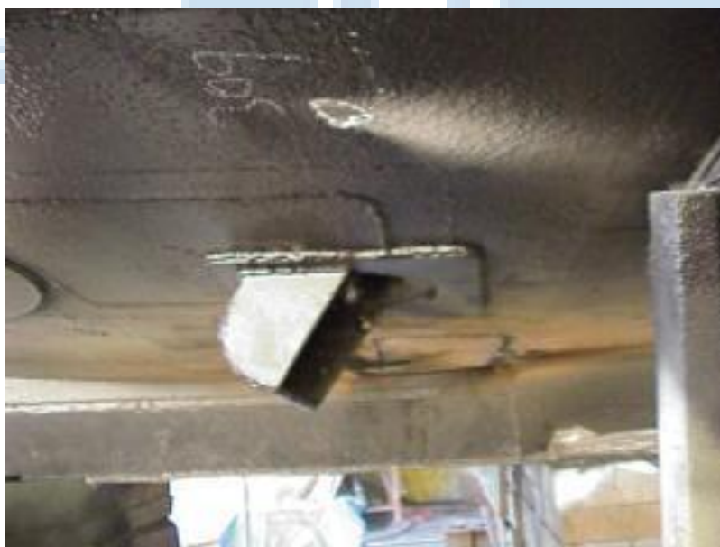
Foto 14. Deflector instalado en la base del casco del B/O Francisco de Ulloa, a un lado de la toma de enfriamiento de la máquina principal del barco.
